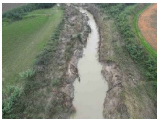
Divagazione planimetrica dell'alveo: Diffuse erosioni spondali a valle dell'evento di piena
