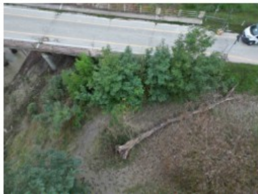
Trasporto materiale vegetale: Tronco rimosso dalla luce del ponte a seguito dell'evento di piena
