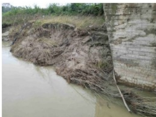
Inquadramento idraulica: Sponda in erosione a monte della pila P1
