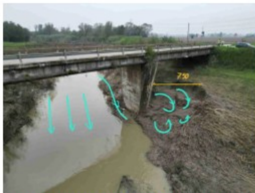
Annotazioni rischio idraulico: Schematizzazione del comportamento idrodinamico della corrente attorno a pila P1, causa della buca di erosione
