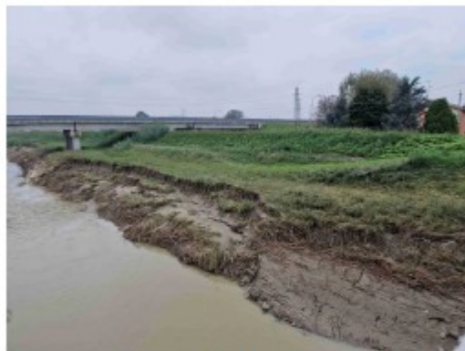
Inquadramento idraulica: Sponda sinistra dell'alveo inciso a monte del ponte in erosione
