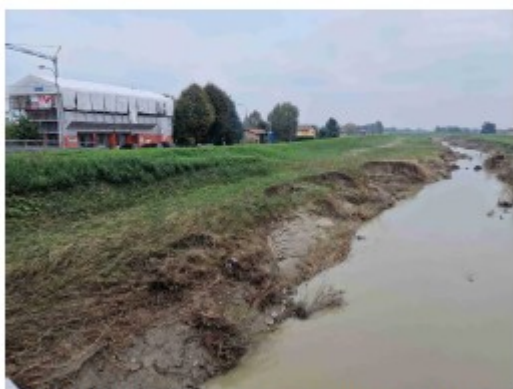
Inquadramento idraulica: Sponda sinistra a valle del ponte, in evidente erosione
