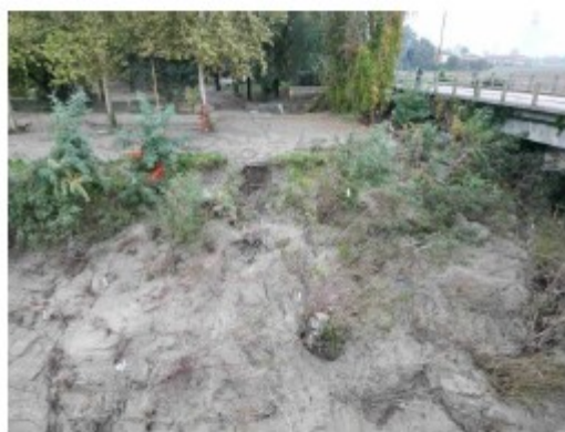
Divagazione planimetrica dell'alveo: Erosione spondale a monte del ponte in destra idraulica
