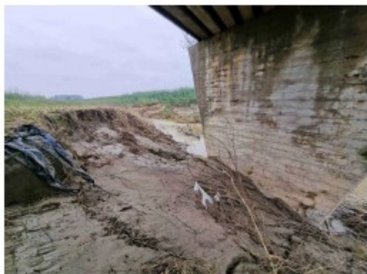
Inquadramento idraulica: Erosione localizzata di scia a valle e sulla sponda sinistra
