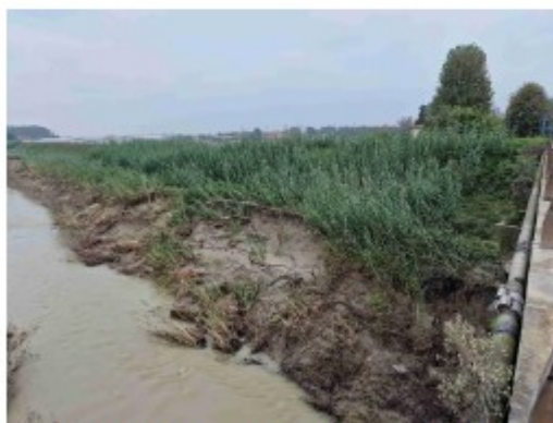
Divagazione planimetrica dell'alveo: Erosione spondale dell'alveo inciso in destra idraulica a valle del ponte
