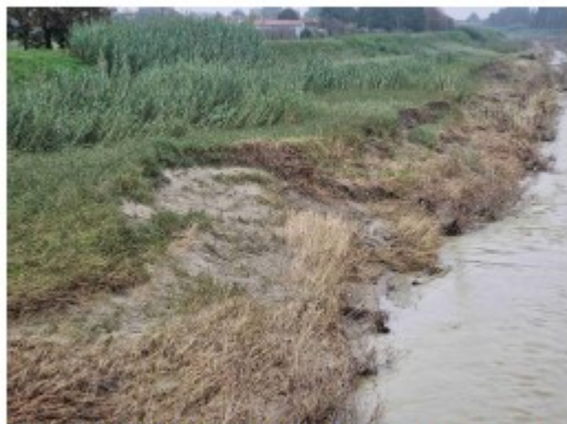
Divagazione planimetrica dell'alveo: Erosione spondale in corrispondenza della briglia a valle del ponte
