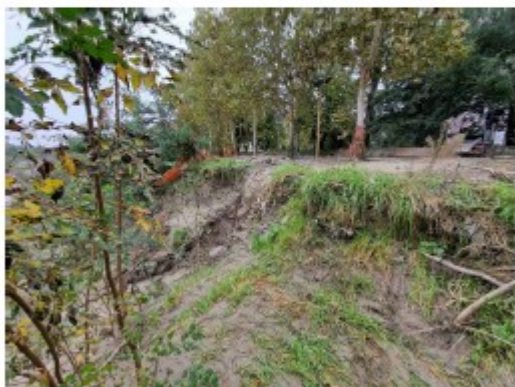
Divagazione planimetrica dell'alveo: Erosione spondale a monte del ponte in destra idraulica
