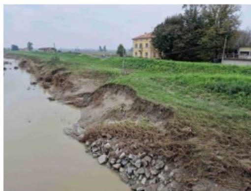
Inquadramento idraulica: Sponda destra a valle del ponte in evidente erosione
